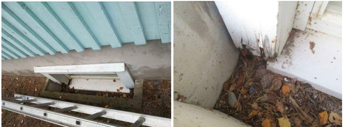
Kuvat 30 ja 31. Ikkunoiden maanpinnan alapuolisilla osilla sijaitsevat puurakenteet ovat lahovaurioituneet.
