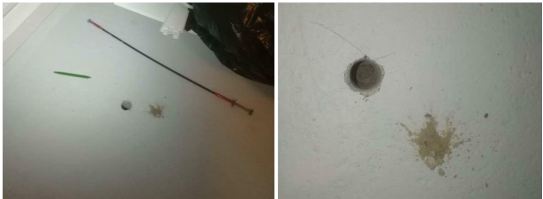
Kuvat 5 ja 6. Rakenneavaus varastotilan 0.10 lattiassa. Avauskohdalla alapuolinen hiekka oli kuivaa.
