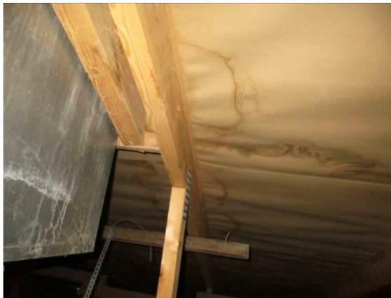
Kuva 36. Aluskatteessa havaittiin paikoin vanhoja kosteusjälkiä.
