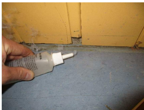
Kuva 17. Tilan 1.15 nurkkauksessa jalkalistan taustalla havaittiin ilmavuotoa merkkisavulla tarkasteltuna.
