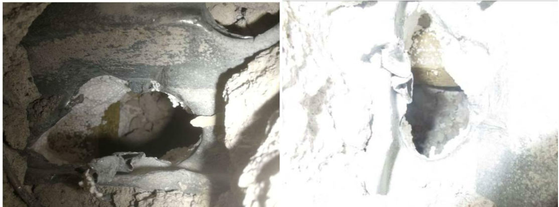
Kuvat 13 ja 14. Avauskohdalla betonilaatan alla oli havaittavissa kuumasinkitty liittolevy. Betonipalkin kyljessä on 50mm x 50mm EPS-eristeiden kannake. Pohjalla rakennusaikaista betonimurua.
