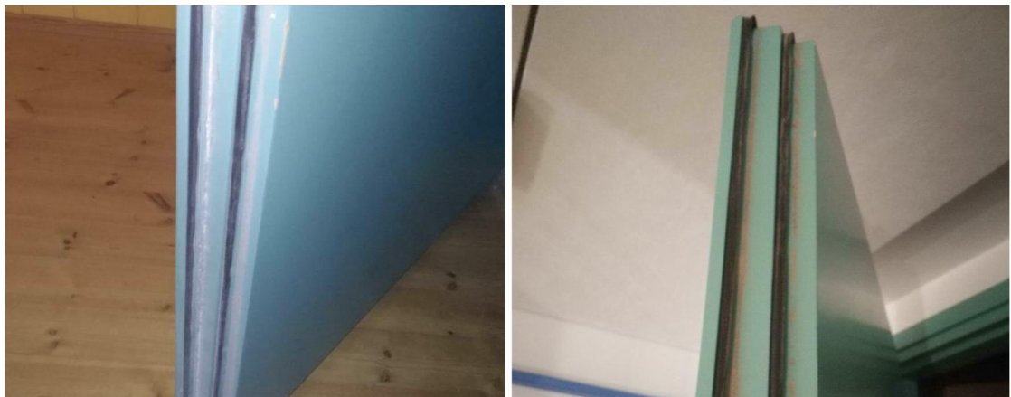
Kuvat 20 ja 21. IV-konehuoneen oven syrjässä oli runsaasti pölyä.
