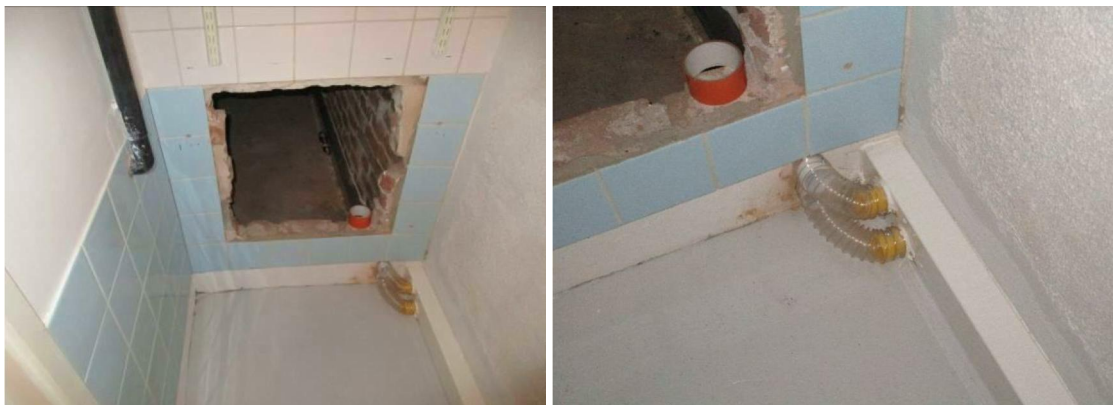
Kuvat 1 ja 2. Portaiden alle avattu aukko siivousvarastossa 0.5. Kellarin maanvastaisten seinien alaosiin oli asennettu valkoiset kotelot, joiden sisällä kulkee poistoputket. Tilaajan kertoman mukaan kotelon taakse seinään on porattu riviin reikiä kapillaarikatkoksi.
