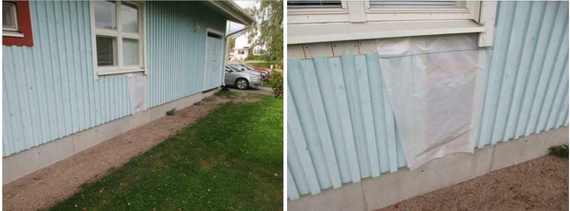
Kuvat 22 ja 23. Urakoitsija oli avannut rakenteet ja suojannut ne tutkimuksia edeltävänä päivänä.
