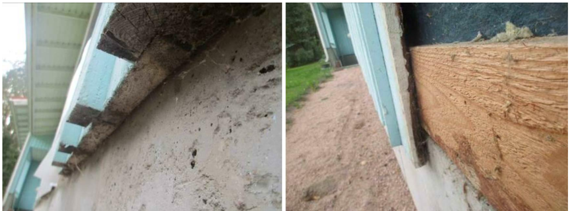
Kuvat 24 ja 25. Ensimmäisellä rakenneavauskohdalla oli havaittavissa, että julkisivuverhouksen tausta ei pääse tuulettumaan. Julkisivuverhouksena toimiva pysty-laudoitus on asennettu kiinni toisiinsa ja taustalla on ainoastaan vaakakoolaus, joka estää ilmavirran kulkemisen julkisivun taustalle.
