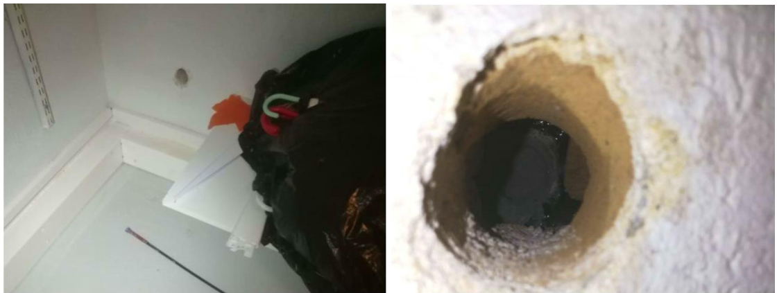
Kuvat 9 ja 10. Rakenneavaus varastotilan 0.10 nurkassa. Tiilimuurauksen takana oli havaittavissa bitumisively.
