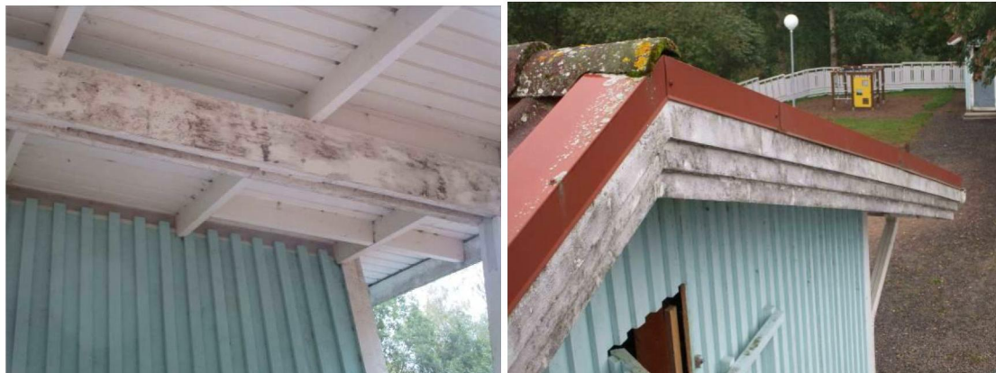
Kuvat 39 ja 40. Ulkopuolen puurakenteet ovat paikoin tummuneet.
