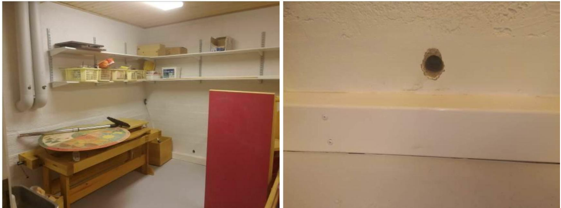
Kuvat 7 ja 8. Porareikä varastotilan 0.3 maanvastaisessa ulkoseinässä.
