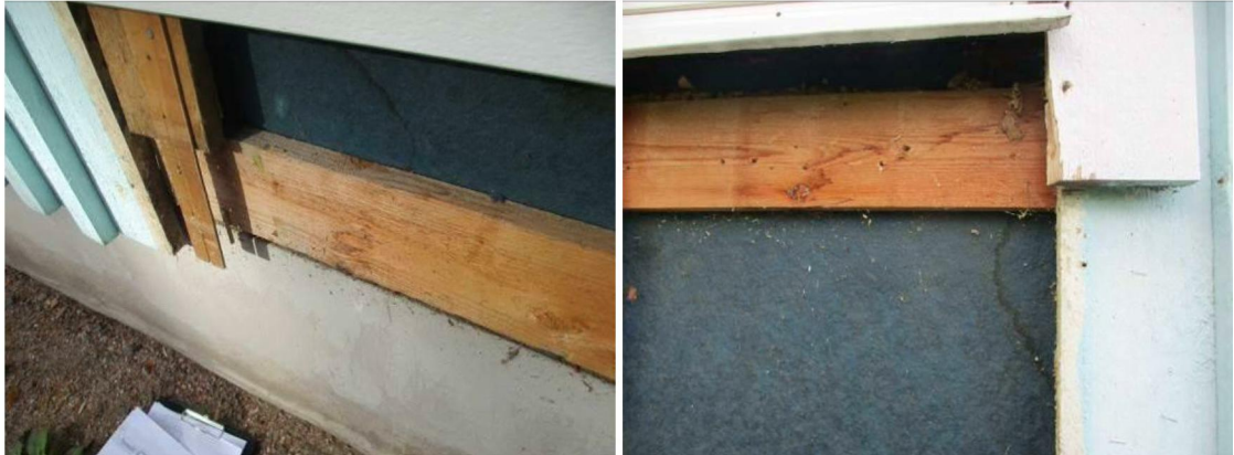
Kuvat 28 ja 29. Vanhoja kosteusjälkiä koolauslaudoissa ja tuulensuojalevyssä.
