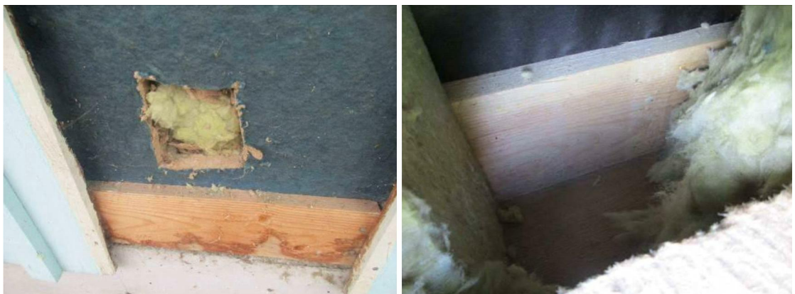
Kuvat 26 ja 27. Tuulensuojalevyn taustalla on havaittavissa 150 mm eristetila ja höyrynsulkupaperi. Alimmassa vaakakoolauksessa vanhoja kosteusjälkiä.
